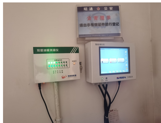
防渗漏检测仪及液位仪
